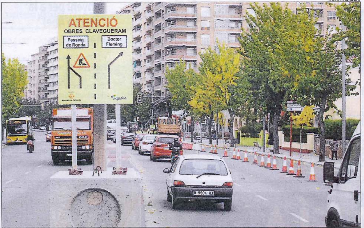
Les desviacions per obres restringeixen el pas en aquesta part de Ronda i l'accés a Doctor Fleming.
